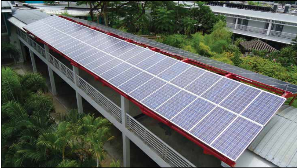
Çatıda güneş paneli uygulamaları
